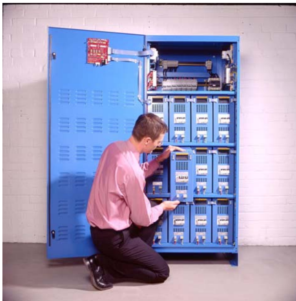
24KVA Systeemkast met lader en omvormermodules met daarboven de klemmenstrook (batterij elders geplaatst)
