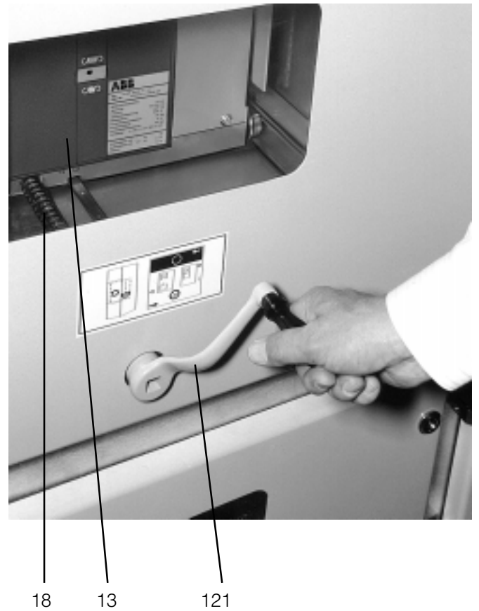
Figura 6/6: Desplazamiento de la unidad de interruptor entre la posición de prueba/seccionado y de servicio. Para ello resultan necesarias unas 20 vueltas de manivela. Hacia la derecha hasta el tope: posición de servicio. Hacia la izquierda hasta el tope: posición de prueba/seccionado
