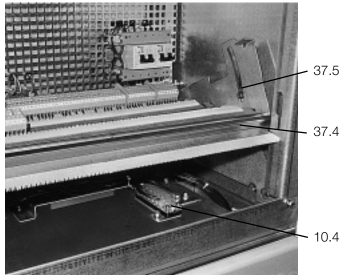
Figura 3/15: Gabinete de baja tensión, soporte regletas de bornes levantado
