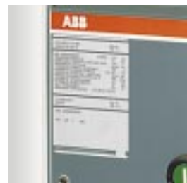
Placa con las características del interruptor situada en el panel frontal.
