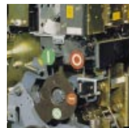
Dispositivo antibombeo mecánico.
