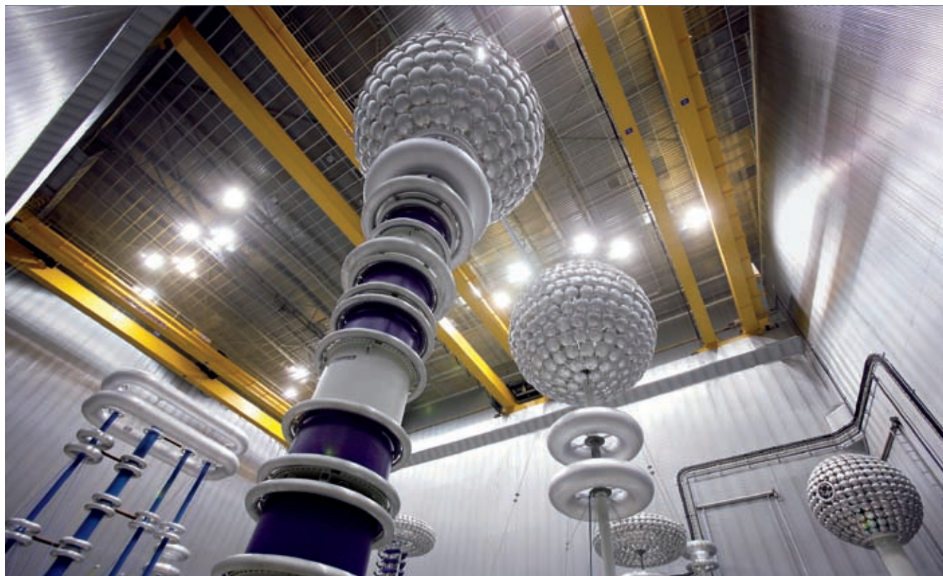
新型特高压试验设备（2009年）
