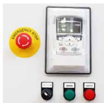
Panel de control y señalización.
