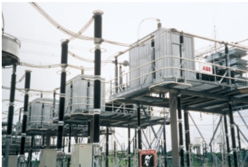
Vue du TCSC du poste Imperatriz
