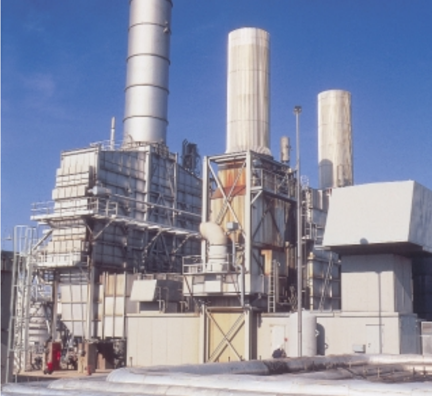
Central eléctrica con acoplamiento calor-electricidad en la refinería de Corinto, Grecia, equipada con dos turbogrupos a gas GT35
