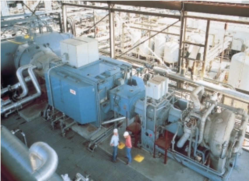
Turbogruppo a vapor VAX con una turbina de alta presión y engranaje en el lado de alternador y una turbina de baja presión con condensador en el otro lado
