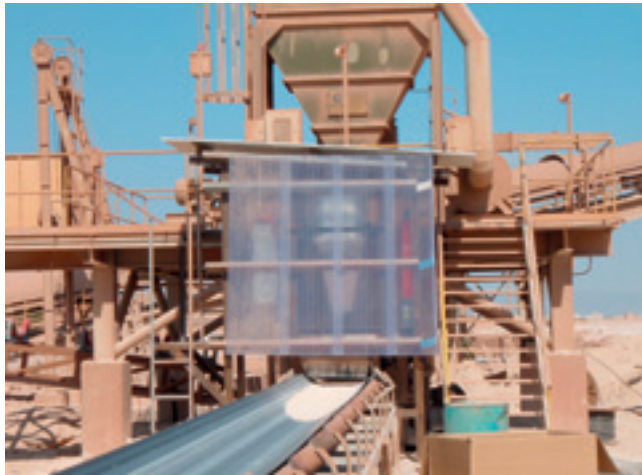
1 First NIR analyzer at the Raysut cement plant in Oman Erstes NIR-Analysegerät im Zementwerk Raysut in Oman
