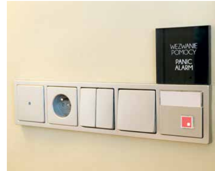
System przyzywowy firmy ABB znalazł się w dwóch pokojach przygotowanych dla osób niepełnosprawnych.
