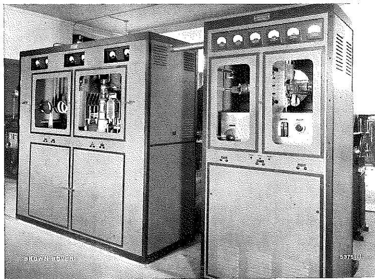
Fig. 12. — Etage pilote (à droite) et étage final (à gauche) de l'installation haute fréquence. A l'intérieur de l'armoire de gauche on aperçoit une des lampes Brown Boveri démontables ainsi qu'une partie du circuit oscillant d'anode.
