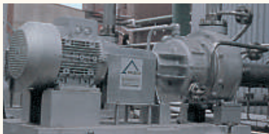
Una de las dos bombas recientemente instaladas en Kemira Kemi AB fueron equipadas con arrancadores suaves PS S de ABB, principalmente para eliminar las elevaciones bruscas de la presión en las tuberías de salida de las bombas.
