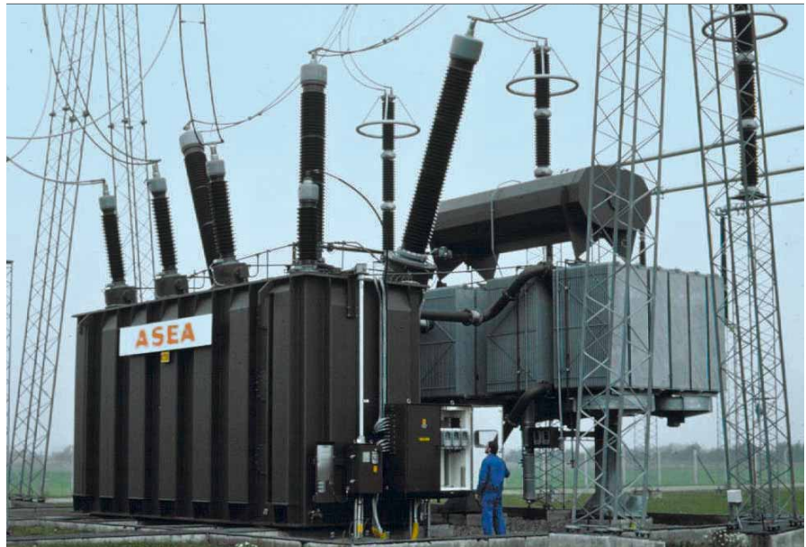
Transformateur Konti Skan II équipé de traversées fabriquées à Ludvika (Konti Skan est la liaison CCHT entre le Danemark et la Suède.)
