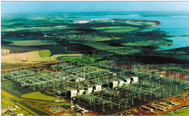
Estación convertidora de Foz de Iguazú con la central de Itaipu de 12.600 MW al fondo
