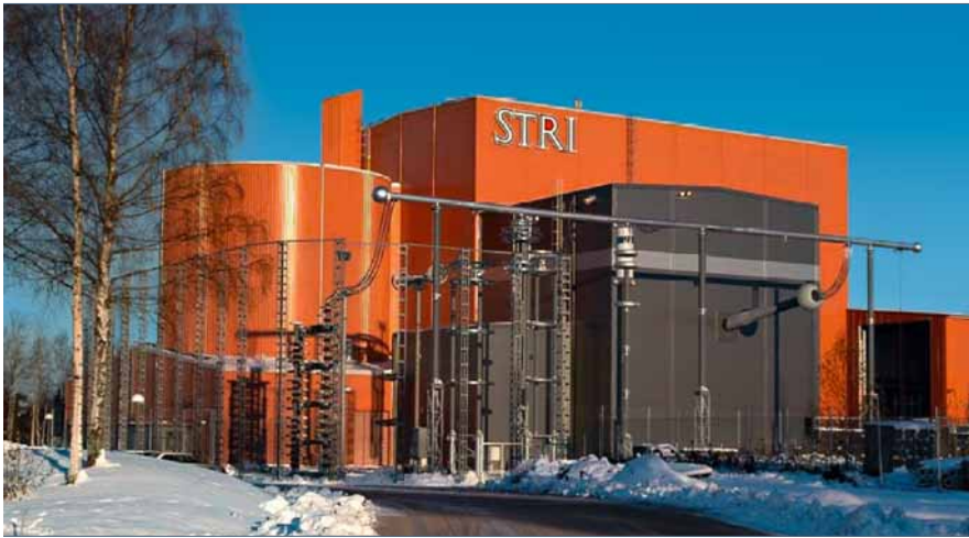
Laboratorio STRI en Ludvika, Suecia, con instalación de prueba para UHVDC a 800 kV
