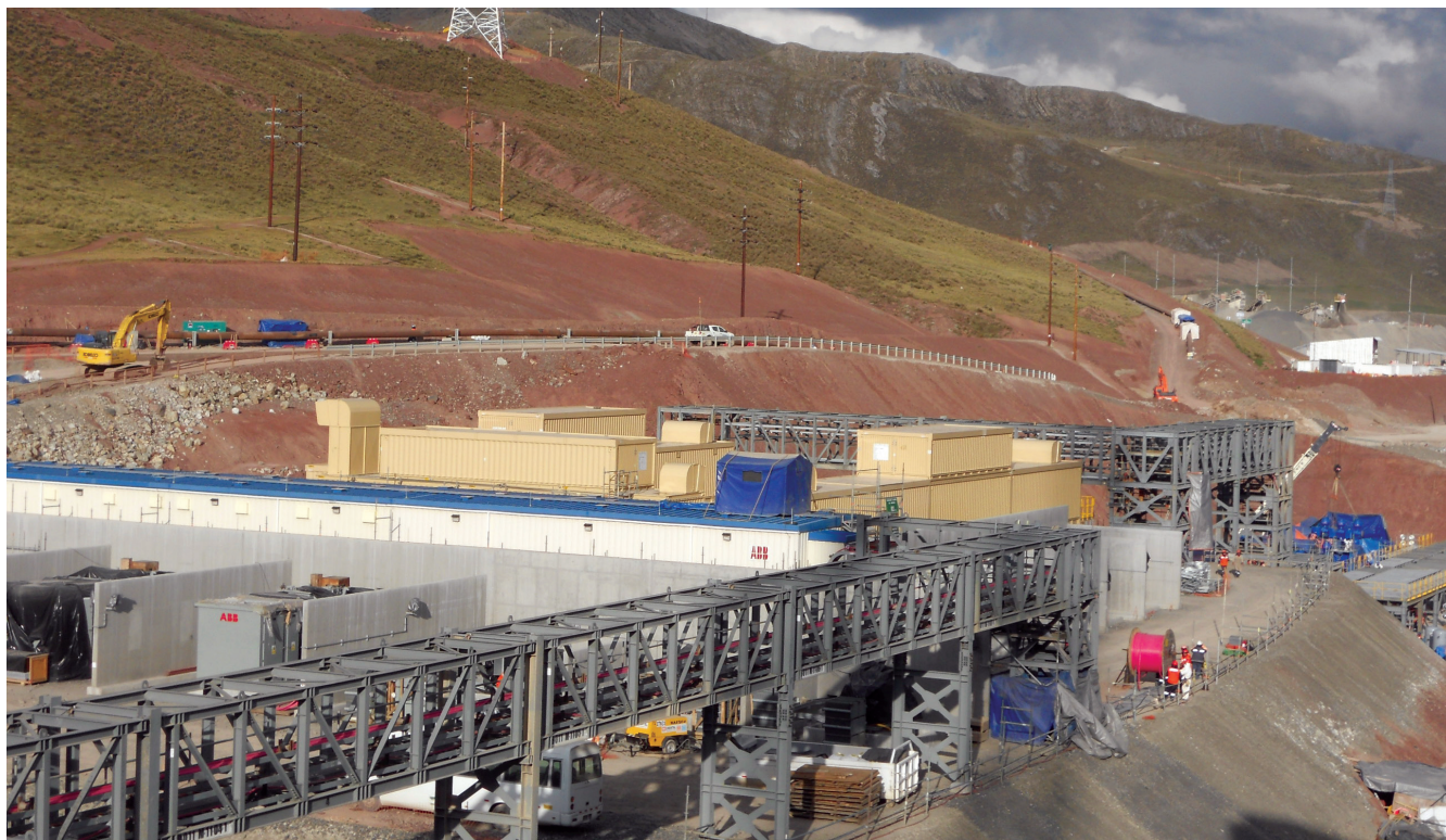
Las salas eléctricas (E-Houses) están diseñadas para mantener los equipos en pleno funcionamiento a pesar de las alturas
