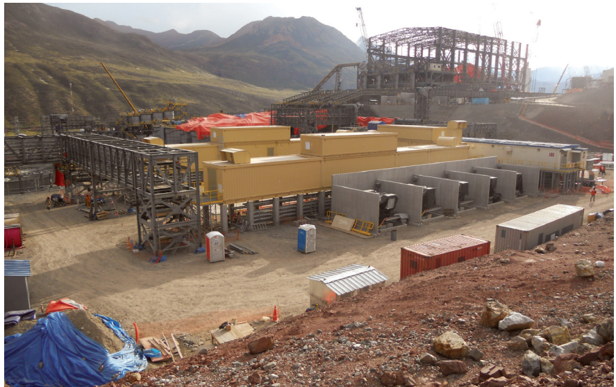
El equipo eléctrico está almacenado en 12 salas eléctricas que van de 42 m 2 a 387 m 2
