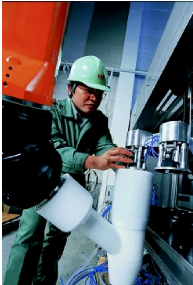
■ ABB 一位技工在检查 CBS 装置。
