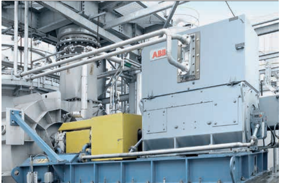
1 Transmisión típica formada por un soplador (izquierda), un árbol (atraviesa la caja amarilla), una reductora (bajo el aislamiento acústico amarillo delantero) y un motor con refrigerante (derecha).
