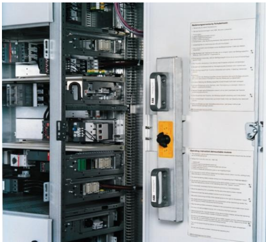
Rys. 55 / Fig. 55 Otwarte drzwi kablowe z instrukcją obsługi uchwytu serwisowego. Open door with service handle and operating instruction.
