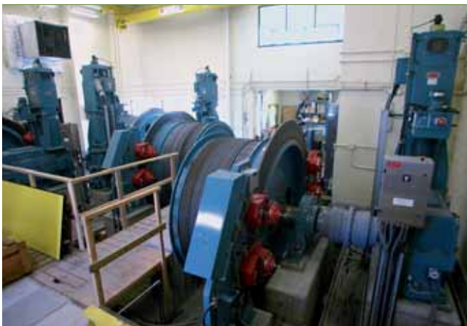
5 Ein Blick in den Windenraum mit den vier Winden zeigt, wie begrenzt der Platz in dem Gebäude ist.
