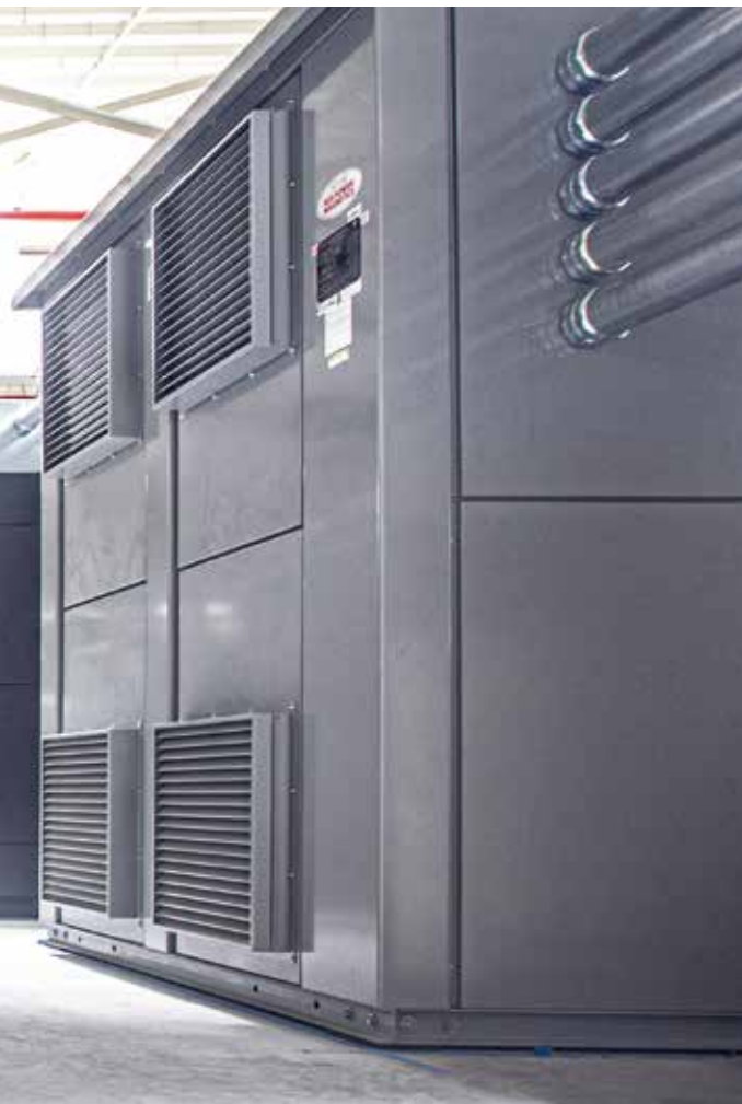
图片: GIGA 数据中心
