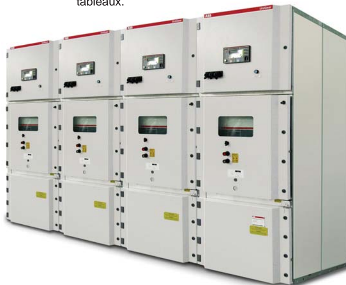
Unité REF542 plus installée dans un tableau isolé dans l'air.
