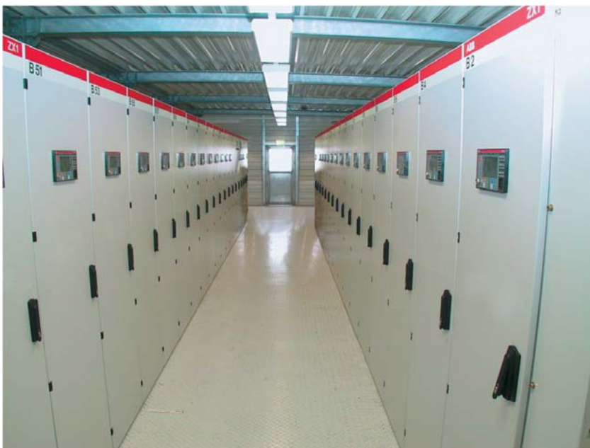
Unité REF542 plus installée dans un tableau isolé dans le gaz.
