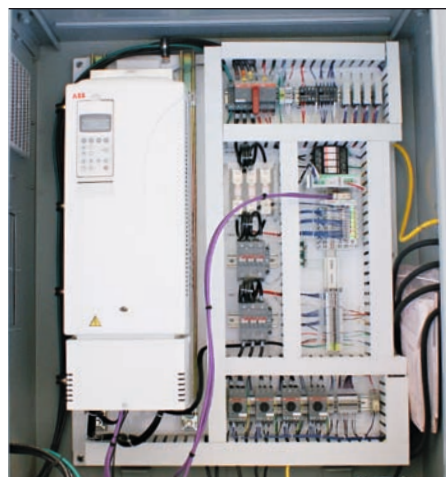
2 Variateur régénératif ACS800-U11 (photo © Uni-Systems)
