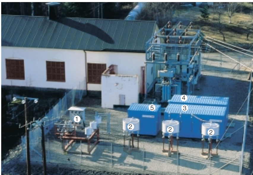
Testinstallationen vid Hellsjön. Världens första HVDC Light-överföringslänk har kapaciteten 3 MW ±10 kV och använder en 10 km lång AC-linje som för tillfället inte är i reguljär drift. 3
