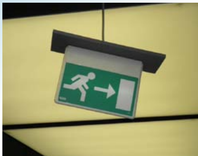
Foutief aangesloten armatuur
