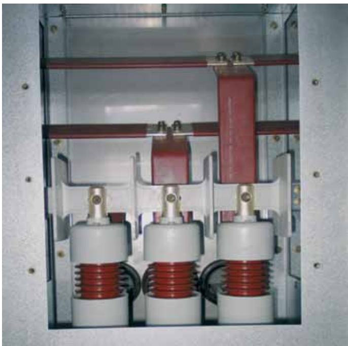
Figura 63: Seccionador de barra en posición "cerrado"
