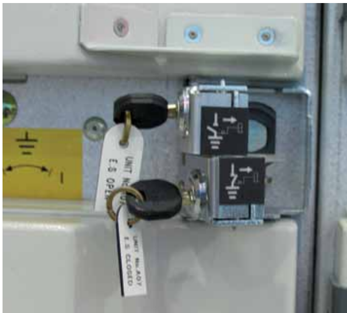
Figura 6: Doble enclavamiento por llave en el seccionador de tierra
