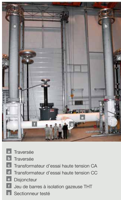
6 Installation d'essais de commutation du sectionneur au laboratoire STRI
