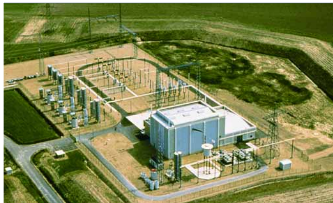
Station de conversion de la liaison CCHT par câble de la Baltique
