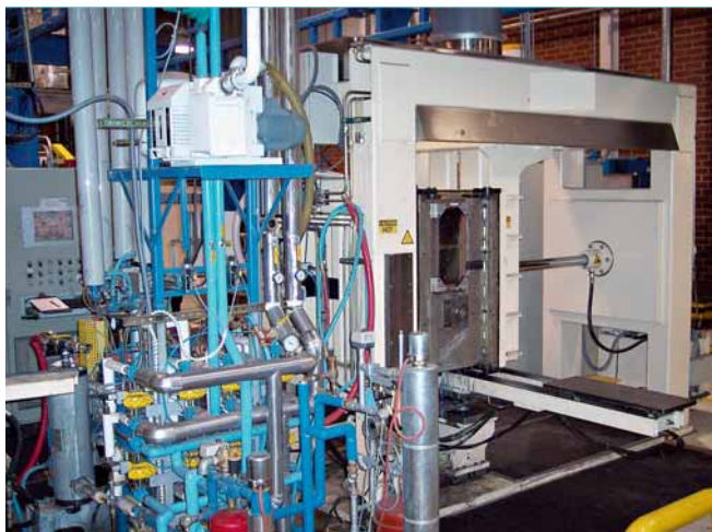
5 Presse à gélification sous pression automatisée (GPA) dans l'usine ABB de Pinetops en Caroline du Nord (Etats-Unis)
