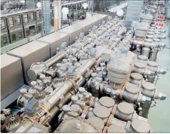
3a 170 kV HV GIS
