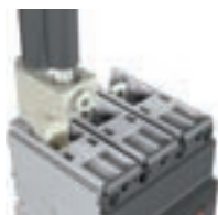
— FCCuAl externer Anschluss mit Kabeln
