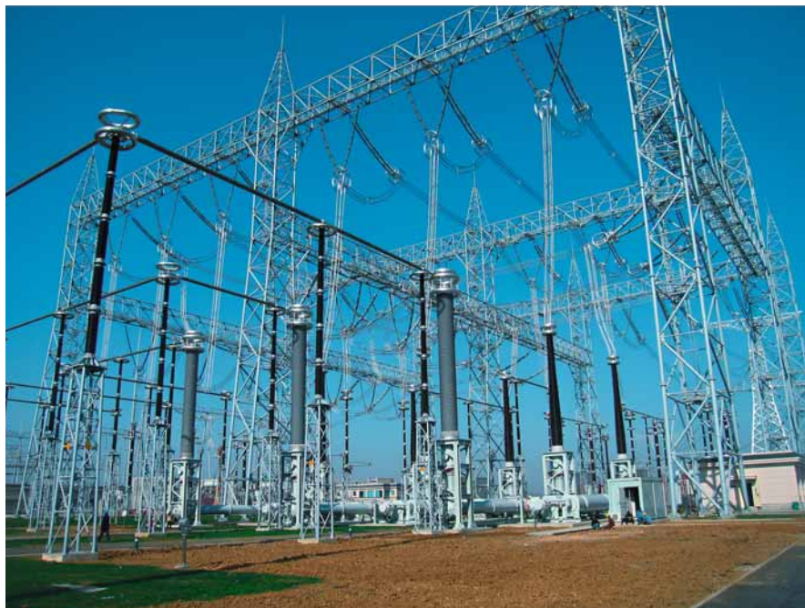
7 Poste à isolation gazeuse de 1 100 kV, Jingmen (Chine)
