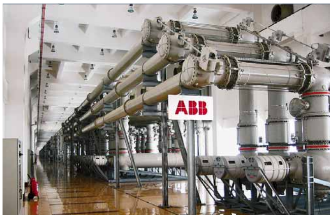
5 Poste à isolation gazeuse de 550 kA sous 550 kV (4 000 A) installé dans le barrage de la centrale chinoise
