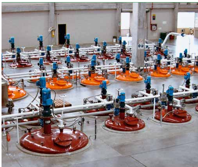
6 Lignes raclées, usine de peintures Pintuco (Colombie)
