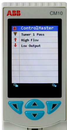
Figura 3 Pantalla de estado de alarma
