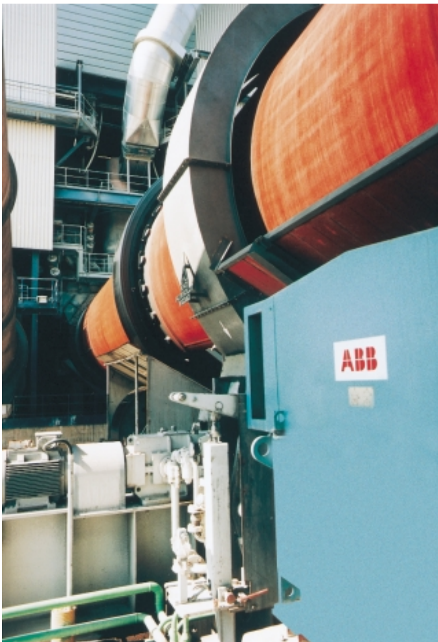
Les fours rotatifs sont entraînés par deux entraînements à convertisseurs U et moteurs de 490 kW.
