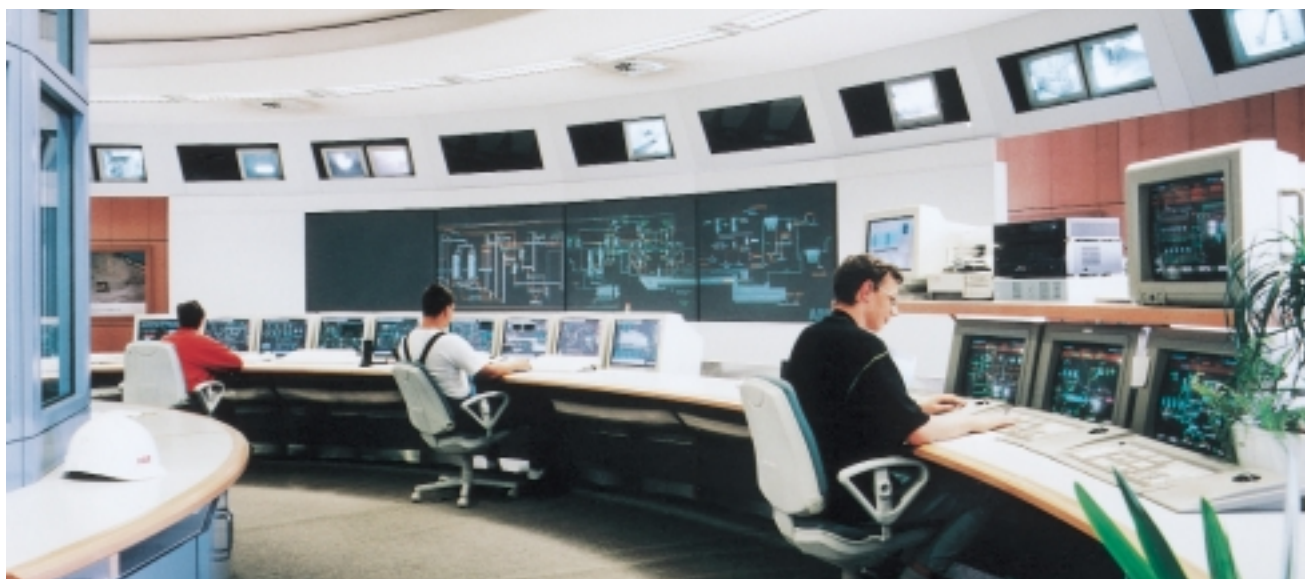
Le nouveau poste de conduite central. Il se trouve près de la nouvelle ligne de four 5 et remplace 12 stations de conduite décentralisées.
