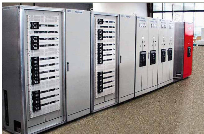
5 Installation électrique sécurisée en armoires
