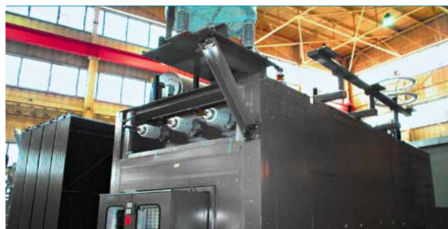
9 Transformateur ConEdison ultrasilencieux avec caisson d'insonorisation
