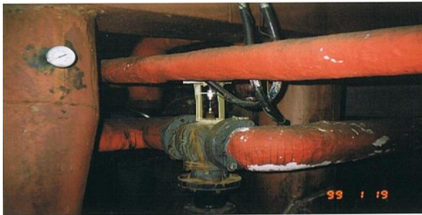
Fotografía 3: Aislamiento térmico dañado
