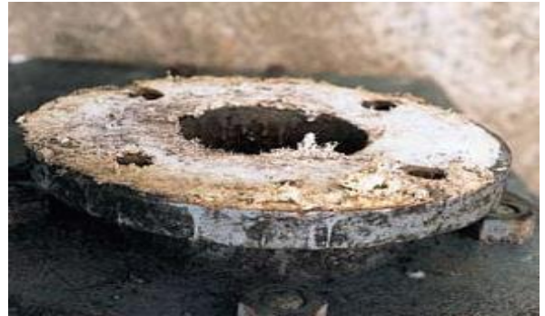
Fotografía 6: Junta dañada en la brida de tubo
