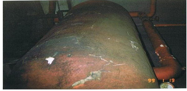
Fotografía 2: Aislamiento térmico dañado
