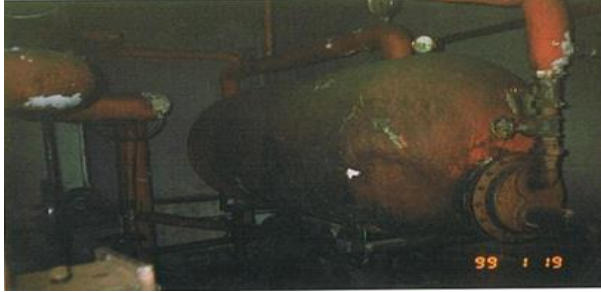
Fotografía 1: Aislamiento térmico dañado
