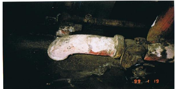
Fotografía 4: Aislamiento térmico dañado y junta en tuberías
