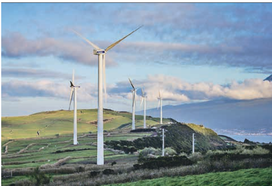
4 Microréseau hybride éolien-diesel (île de Faial, Açores)
