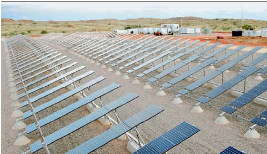
3 Microréseau hybride solaire-diesel (Marble Bar, Australie)
