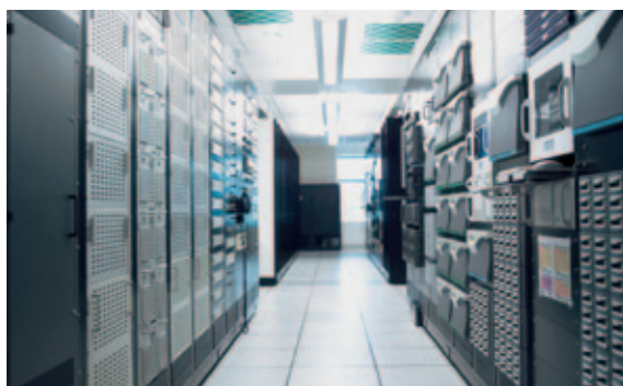
Centres de données / alimentation électrique vitale
