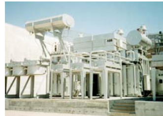
变压器，开关设备，静止无功补偿器和谐波过滤器
