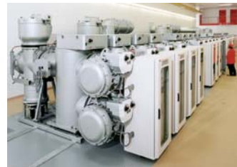
气体绝缘开关设备和工业变电站
