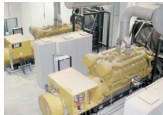
紧急发电和 UPS
