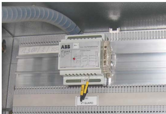
рис.5 – Установка в низковольтный отсек
