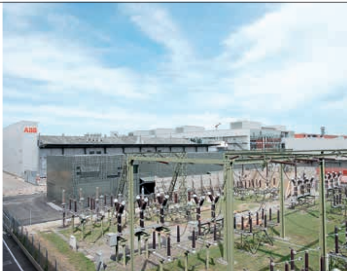
5b La fábrica de GIS AT de ABB se ve detrás de la subestación.
