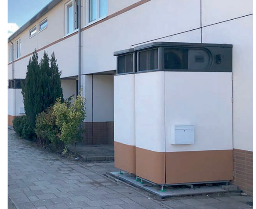
03 Voorbeeld geïnstalleerde energiemodules; elke woning zijn eigen module
