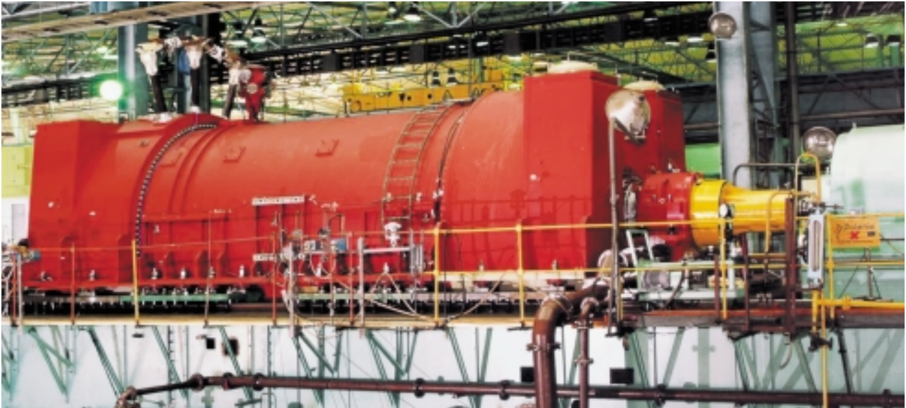
«Topgas» – indirekt wasserstoffgekühlter Generator der Leistungsklasse 500 MVA
