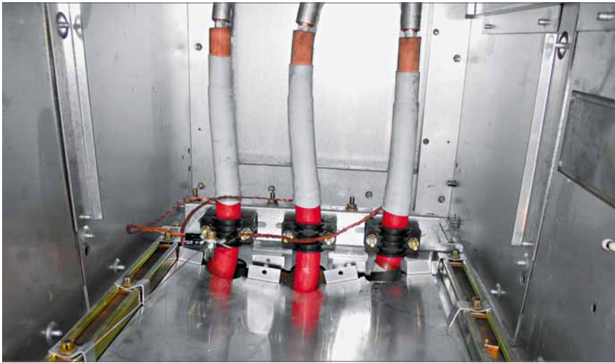
7 Auswirkungen eines 40-kA-Lichtbogens mit Eingriff durch den AE
