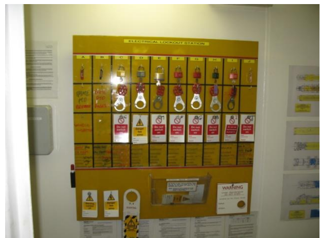
Figura 5. Control de equipo de bloqueo/etiquetado
