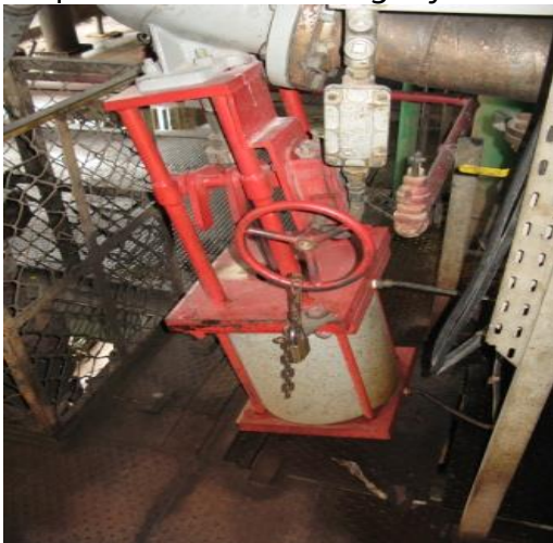
Figura 7. Válvula encadenada y bloqueada pero no etiquetada
