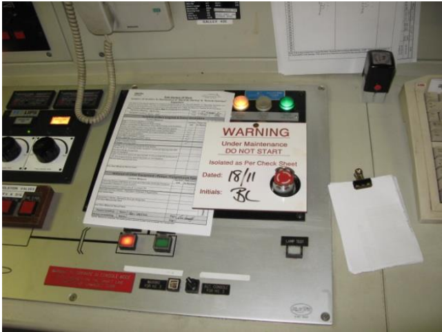
Figura 4. Estación de control también etiquetada
