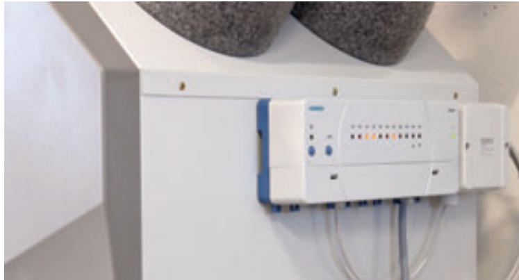
Die kontrollierte Wohnraumlüftung wird ebenfalls über das Synco living bedarfsgerecht angesteuert.
