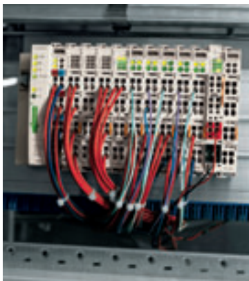
WAGO Feldbusnoten mit Ethernet-Controller, rechts die KNX-Klemme, dazwischen diverse Ein- und Ausgänge.
