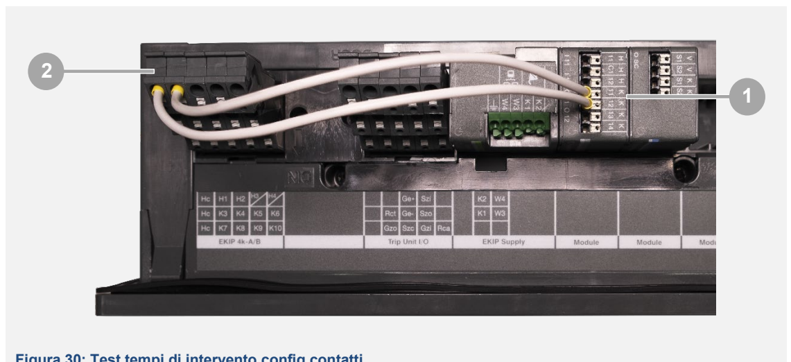
Figura 30: Test tempi di intervento config contatti
