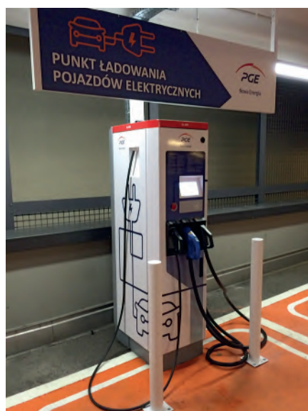
— Stacja Terra 53 C3G przy sklepie Lidl, Poznań.
