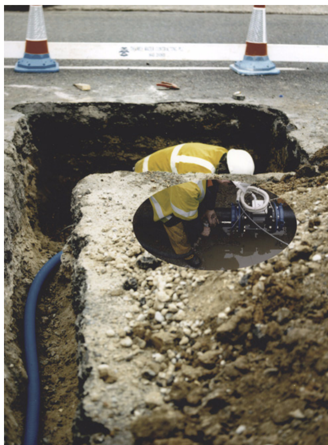
Instalación subterránea del MagMaster
