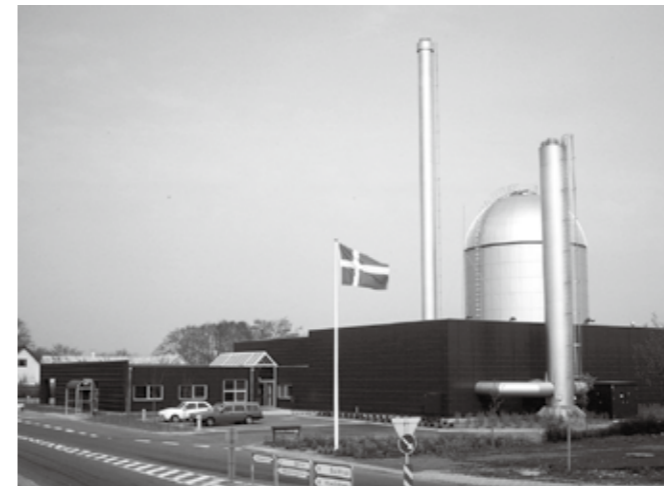
01 电厂(柴油机发电厂和燃气电厂)
