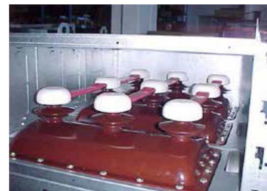
— 24kV母线装配
