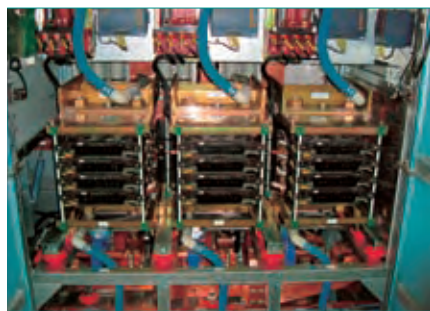
7 配备 ACS6000 变频器中的换流器组
