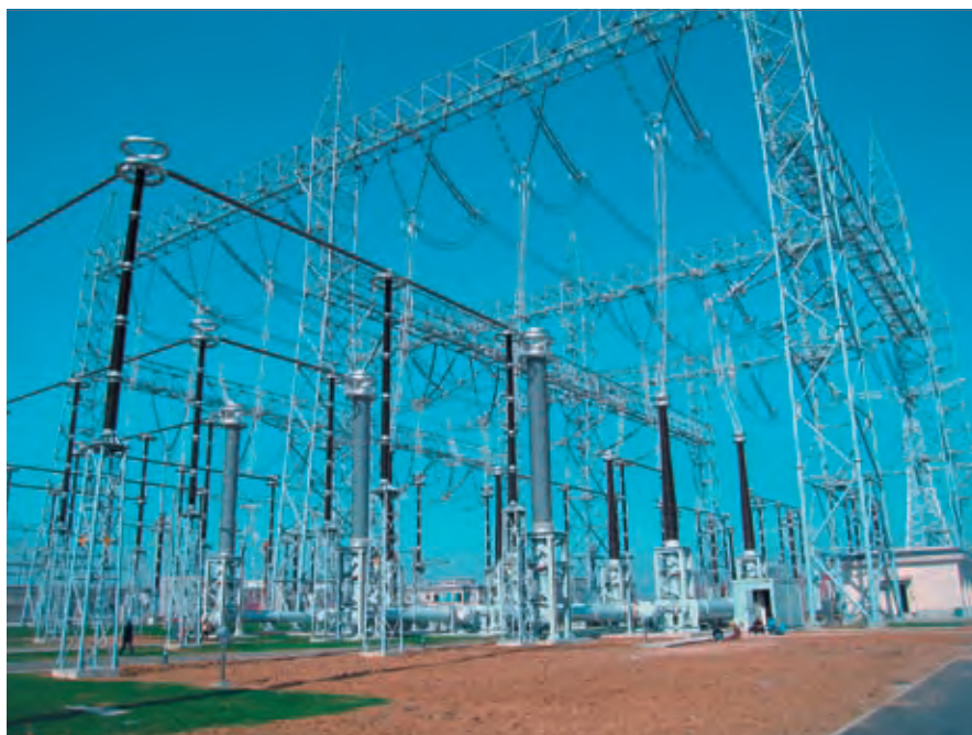
7 安装在中国荆门 1,100 kV 的 GIS 变电站
