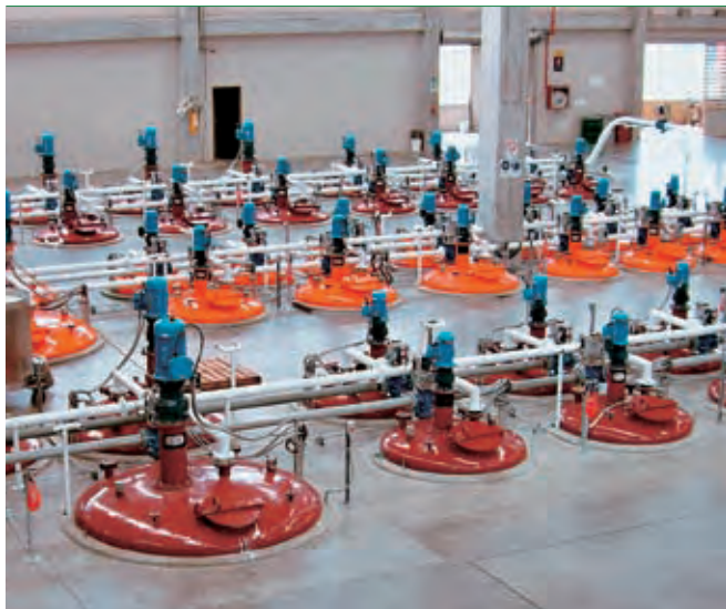
6 安装在哥伦比亚 Pintuco 涂料生产厂中可清理的管道
