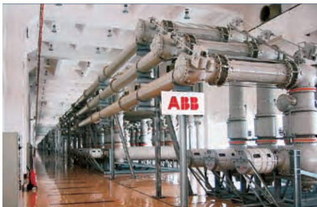
5 安装在中国三峡水电站大坝上，配有 GIS 设备的一个 550 kV 变电站 (额定值为 550 kV，63 kA，4,000 A)
