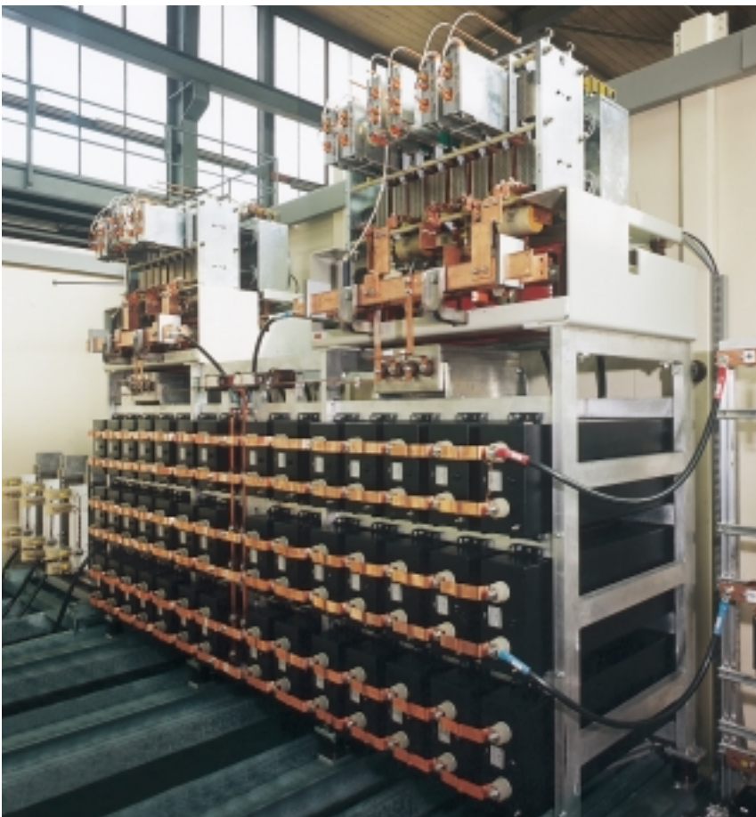
Le convertisseur de tension du DVR à base d'IGCT (état de l'art) monté sur une batterie de condensateurs
