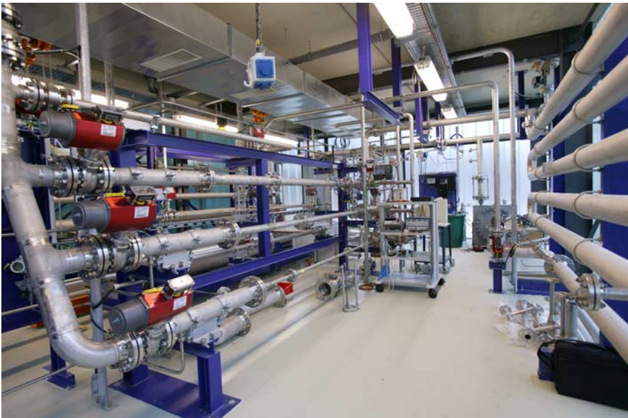
Bild 3-14: Bilder der Prozessgasanlage
