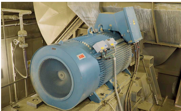
Der mit einem ACS 2000 von ABB drehzahlgeregelte Abluftgebläsemotor des Klinkerkühlers
